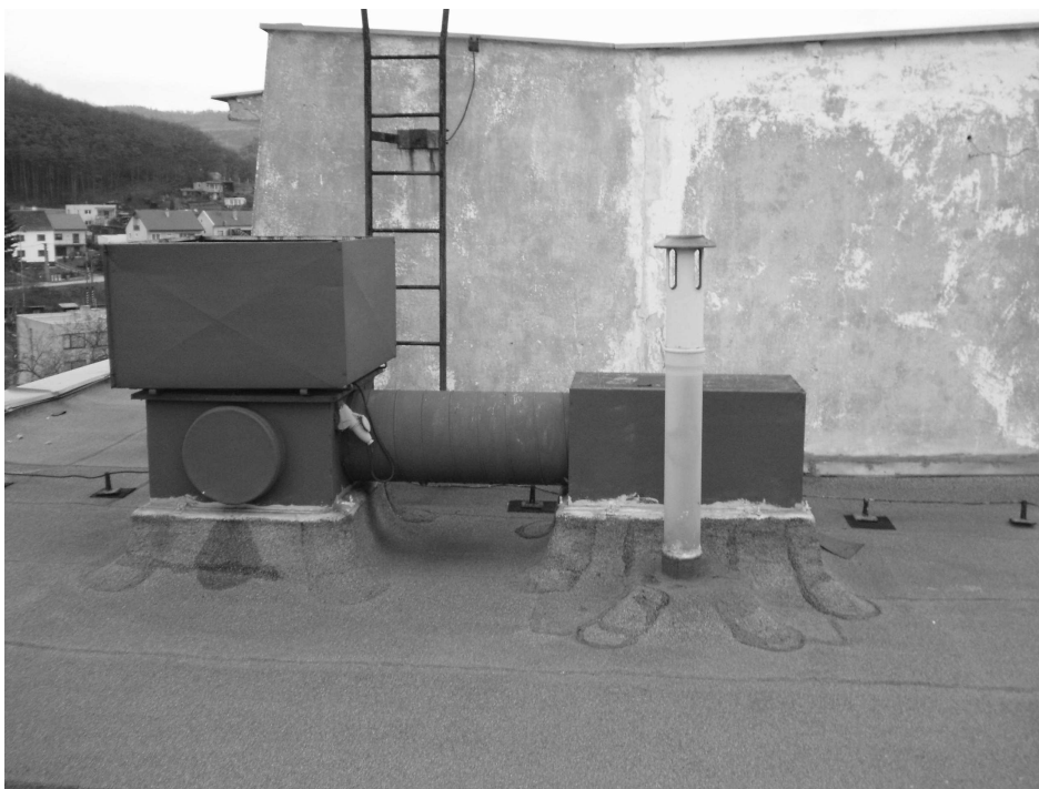
Foto stávajícího střešního ventilátoru NRC
